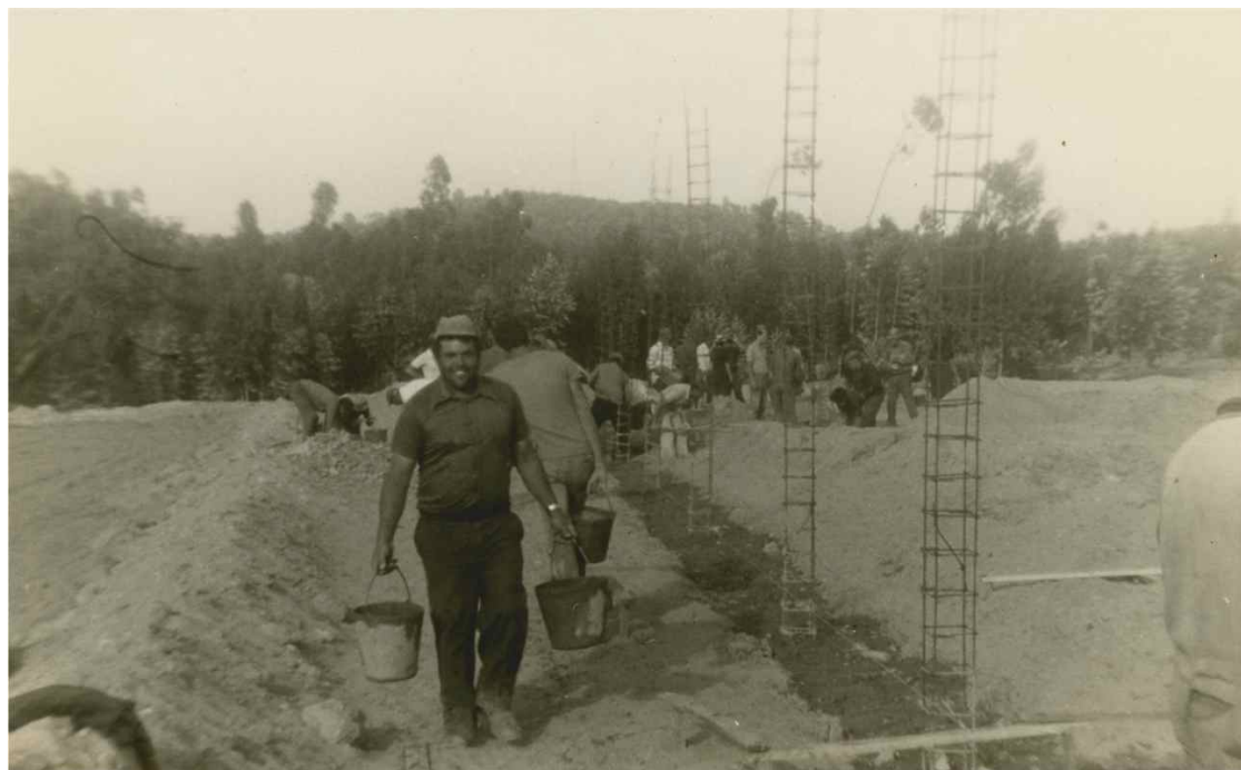
Construção do Salão do Povo do Paiol em jornadas de trabalho voluntário. Anos 80 do século XX. Imagem emprestada pelo Centro de Trabalho do Partido Comunista em Sines. Arquivo Municipal de Sines
